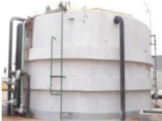
Figure (5) : Bac tampon ou le de pré -désuilage S-101(22/042019)
