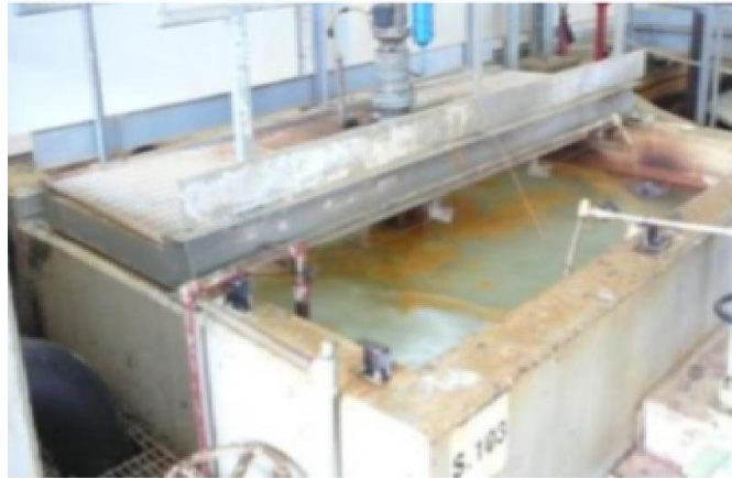
Figure (8) : Cuve floculation « S-103 » (22/042019)
