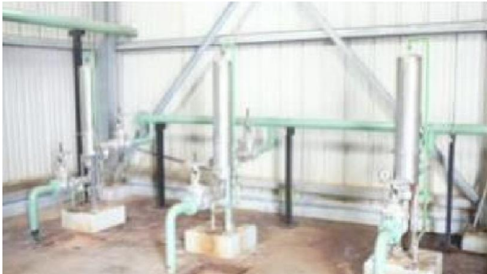
Figure(10) : les filtres à cartouche. (22/042019)
