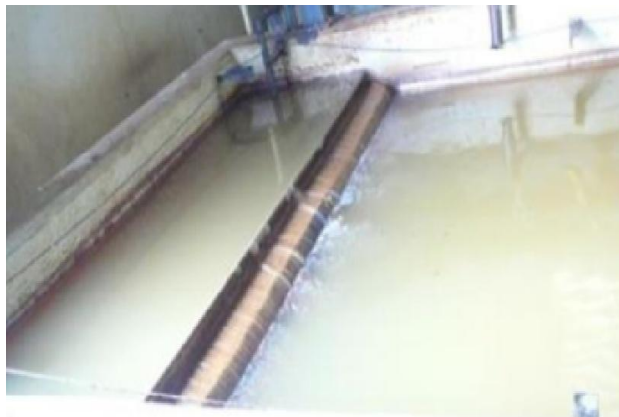
Figure (7) : Corrugated Plate Interceptor CPI « S-102 »(22/042019)
