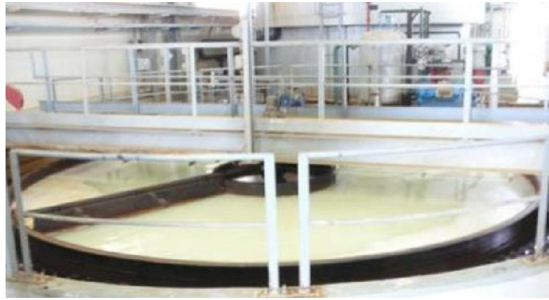
Figure (9) : la cuve de flottation « S-104 » (22/042019)
