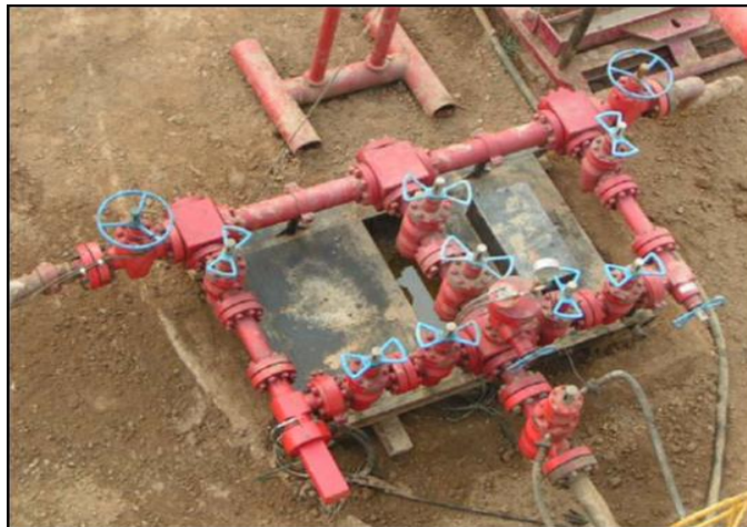
Fig. I.12. UBD Choke manifold
