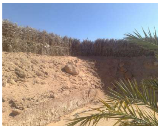
Photo 08 : Brise vent inerte
