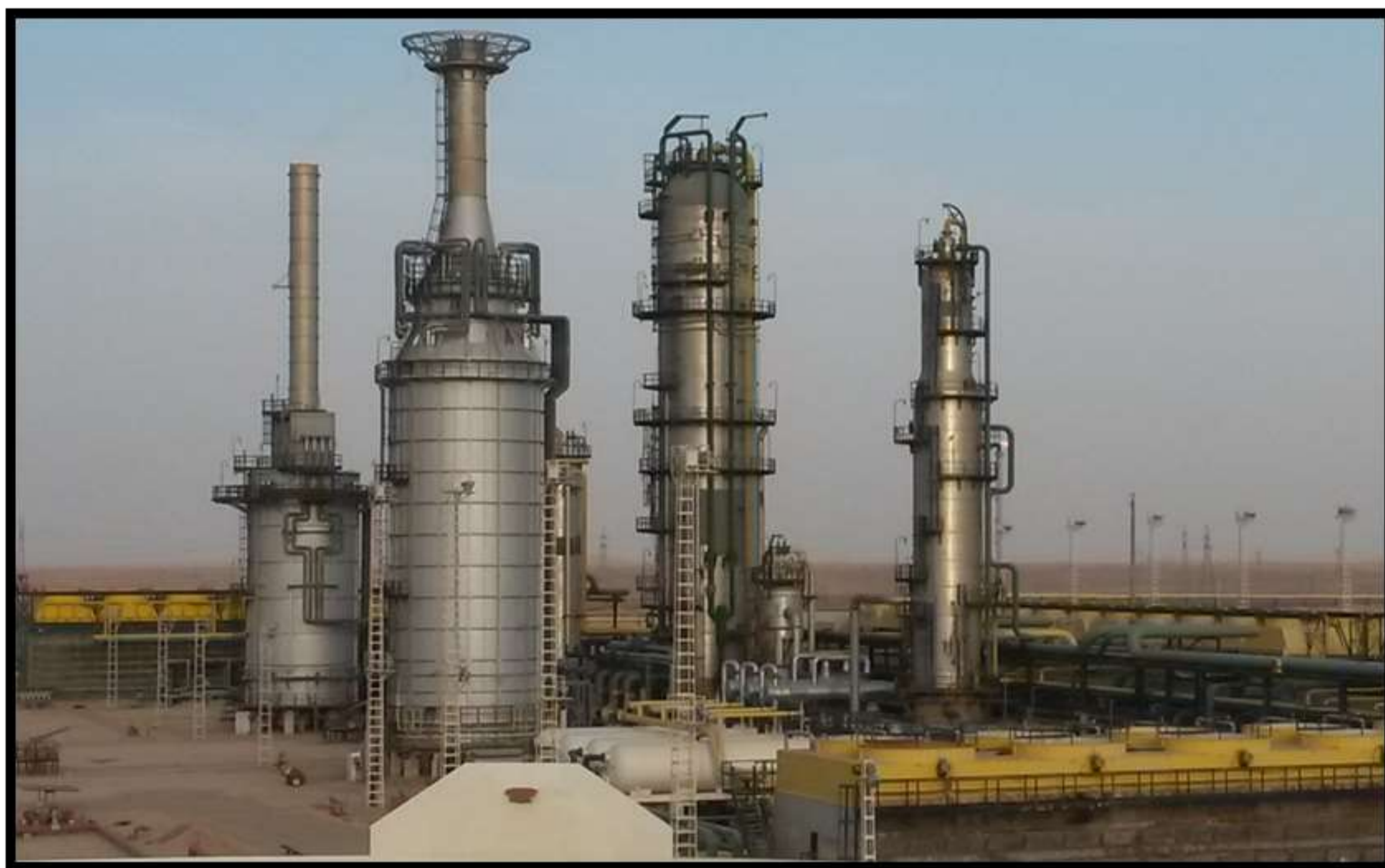
Figure 1: station de déshuilage API- CINA
