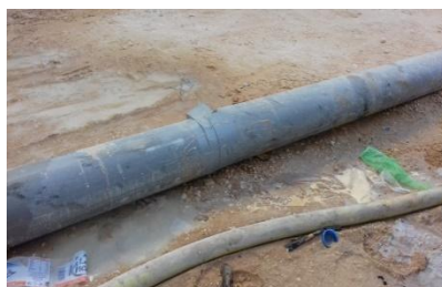
d-Fuite d'eau usée
