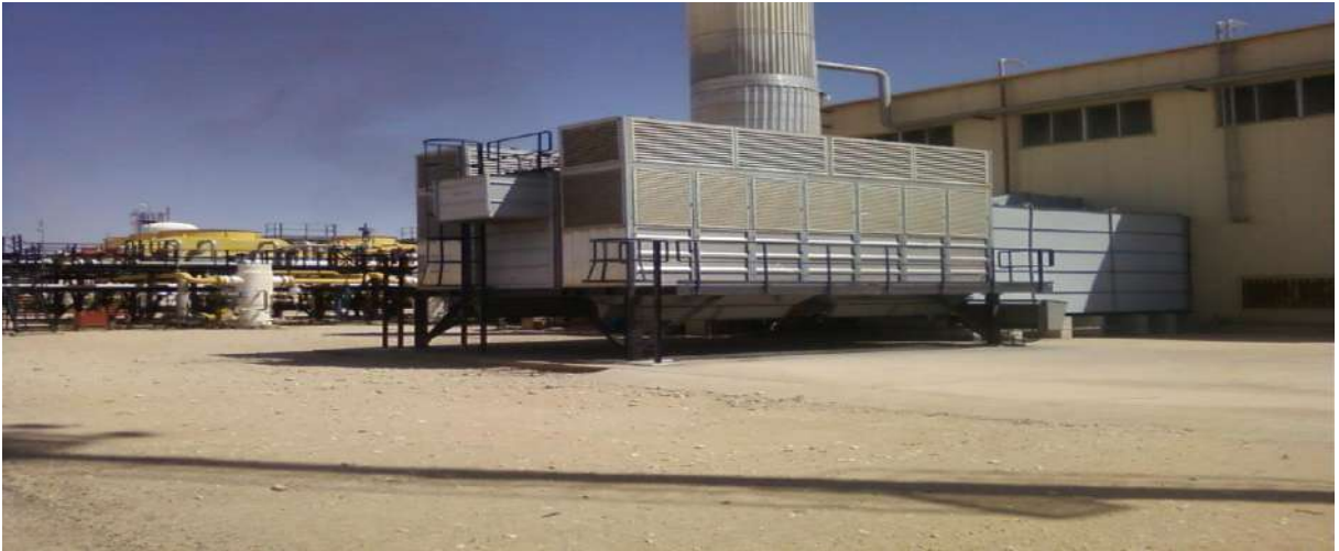
Fig.1.23 : Filtre à air TUD77-8002
