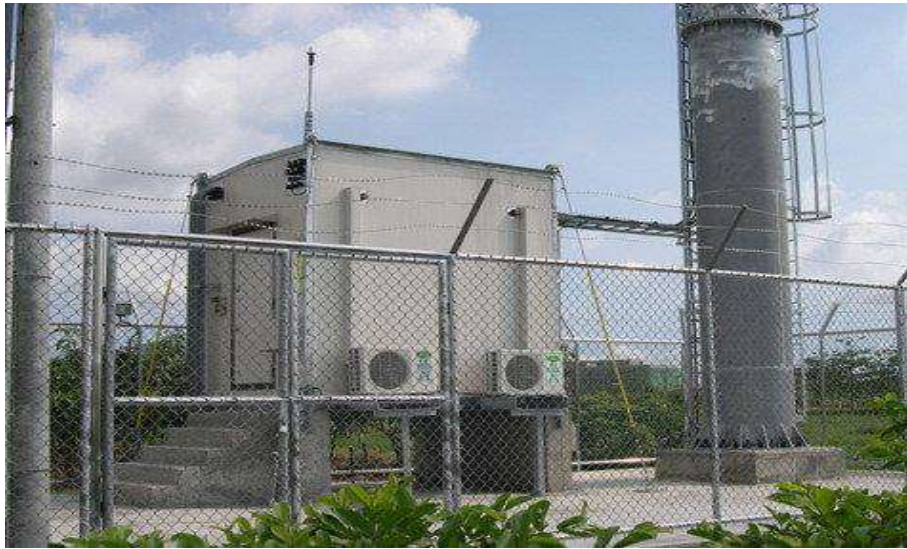
Figure (I .6) : Refroidissement par climatiseur
