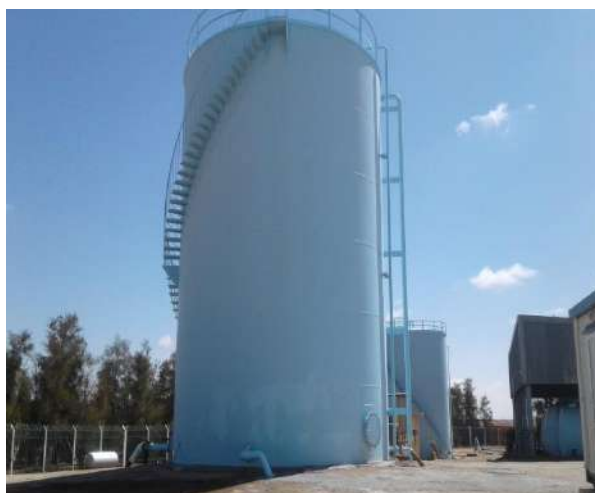
Figure-01- : réservoir eau brute.
