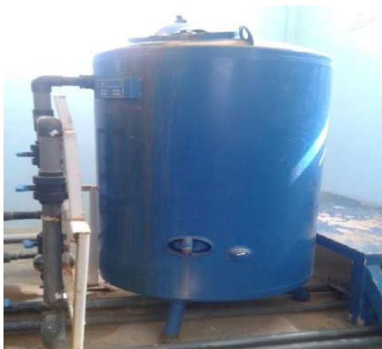
Figure-02- : filtre à sable
