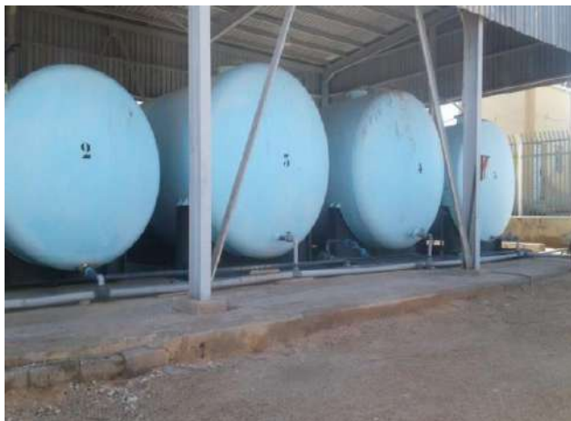
Figure-08- : réservoir de d'eau traité
