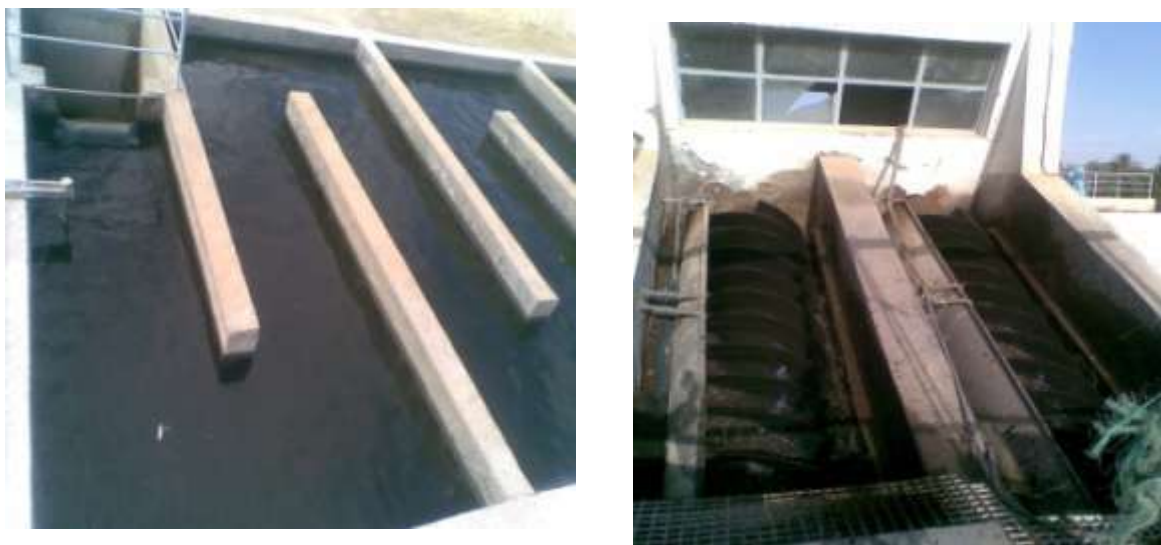
Figure III. 7: vue Bassin de chloration et d'Archimède
