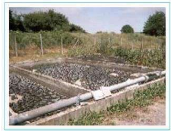
Figure I.5 Boues sèches sur lits de séchage
