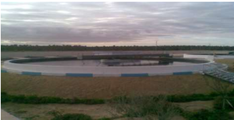
Figure III .6: vue décanteur secondaire
