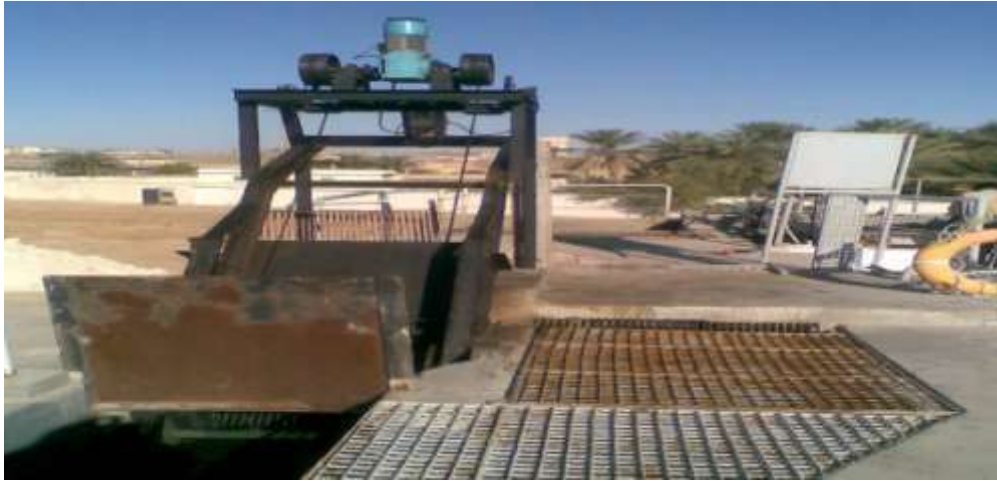
Figure III. 3: vue du Dégrillage
