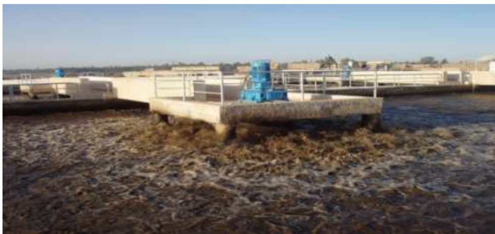
Figure III. 5: vue Le bassin d'aération
