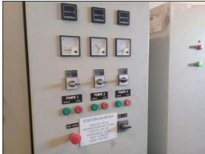
Figure IV.4 : armoire plaque signalétique de station pompage
