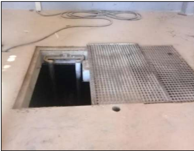
Figure V.1 : l'ouverture de la cuve de poste pompage
