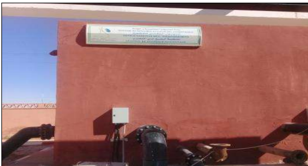
Figure IV.3 : station pompage haï Nasser
