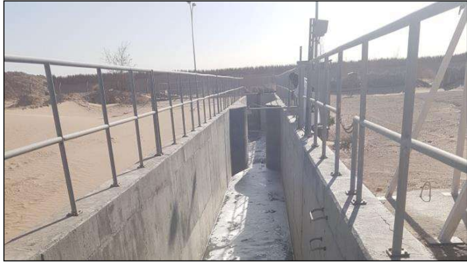
Figure IV.14 : canal d'évacuation des eaux épurée
