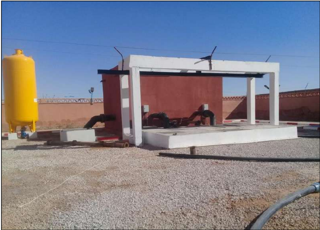
Figure IV.2 : station de refoulement haï Nasse
