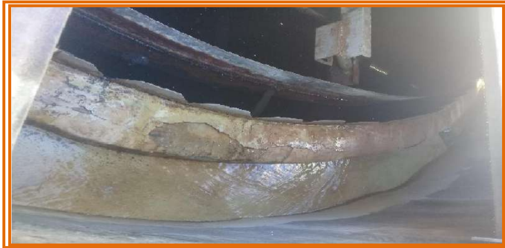
Figure 9 : Bassin de décantation secondaire
