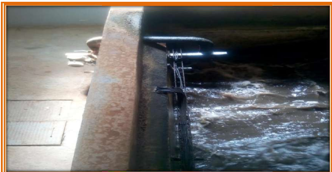
Figure 10 : Point de recirculation
