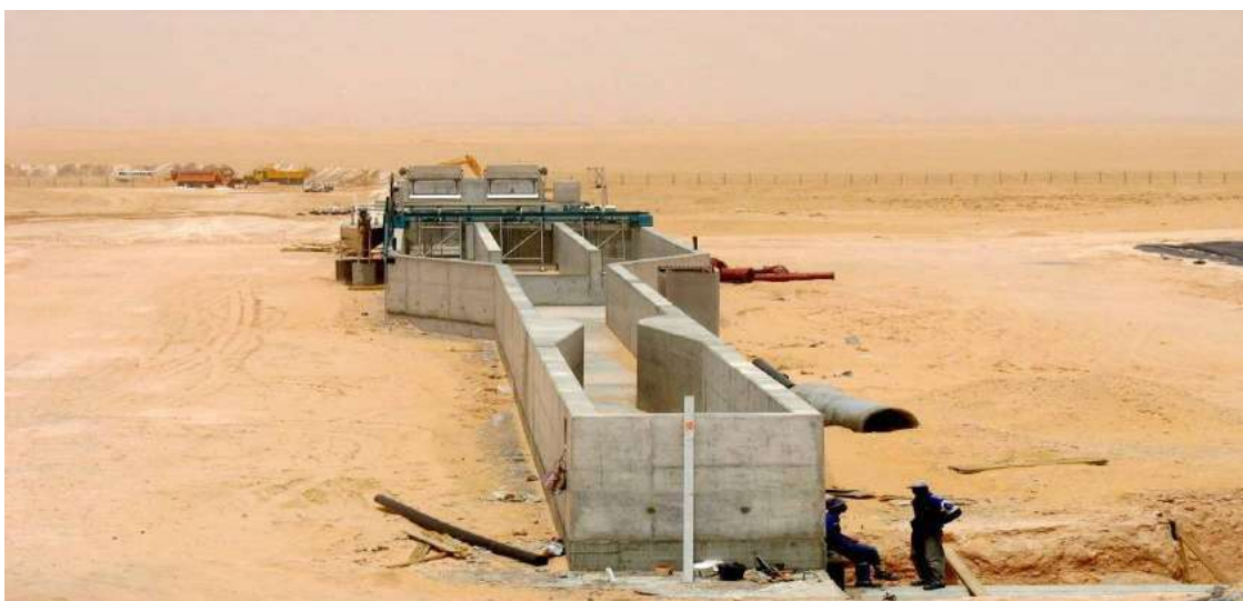
Photo 1 : Ouvrage de prétraitement
