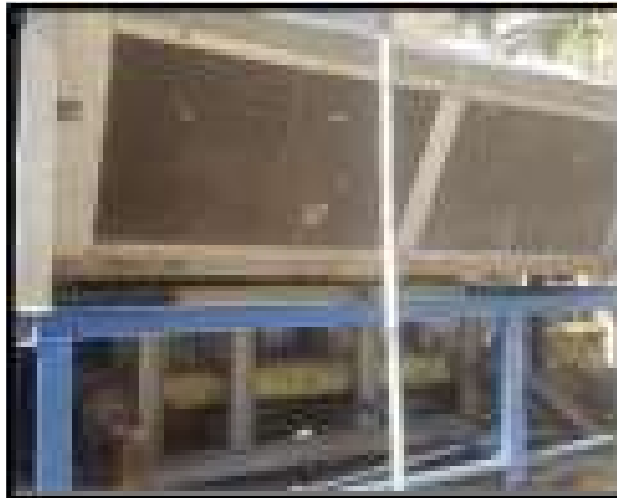
Figure 12: Système de refroidissement d'eau.
