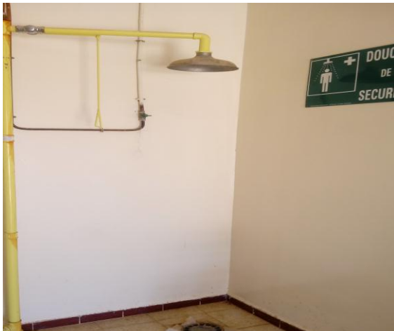
Figure.III.10 : douche de sécurité
