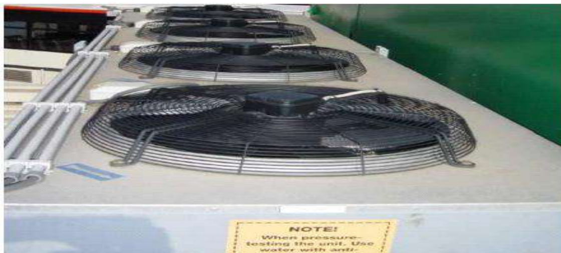
Figure II-12 : système de refroidissement d'électrolyte.
