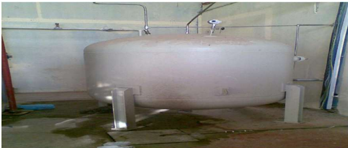
Figure II-14 : réservoir de stockage d'hydrogène.
