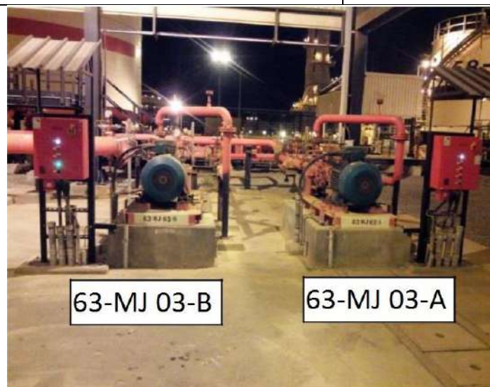
Figure II.3 : Pompes « Jockey » d'eau douce incendie (63-MJ03-A/B)
