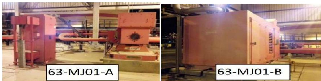
Figure II.4: Pompe d'eau incendie (63-MJ01-A) et pompe d'eau incendie diesel (63-MJ01-B)
