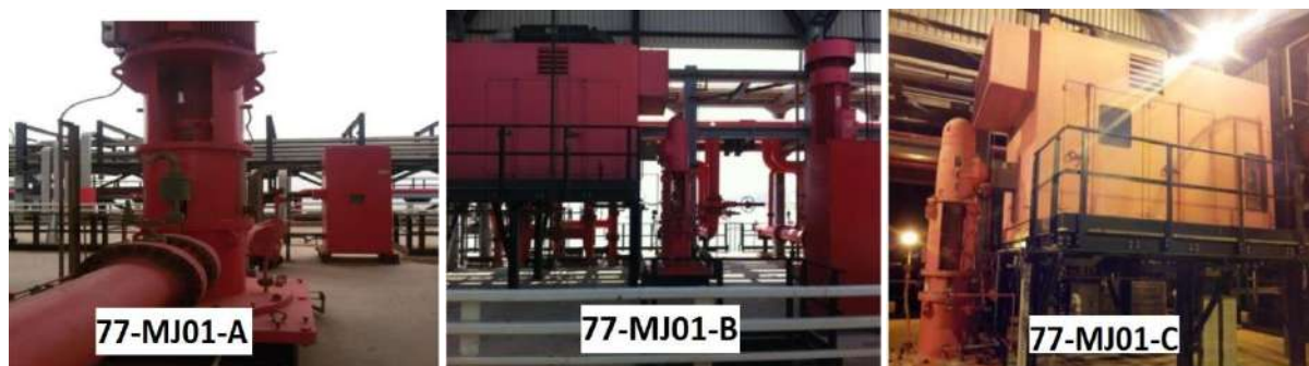
Figure II.5 : Pompe d'eau de mer incendie (77-MJ01-A) et pompes d'eau de mer incendie diesel (77-MJ01-B/C).
