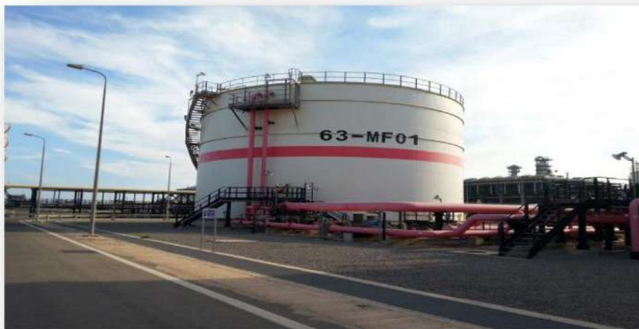
Figure II.2 : Réservoir de stockage d'eau douce anti-incendie 63-MF01
