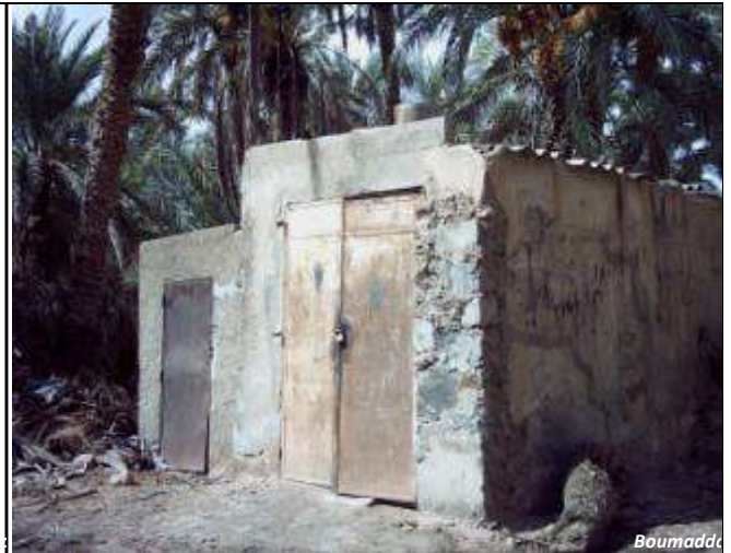
Photo 43 : Etat des abris forages.
