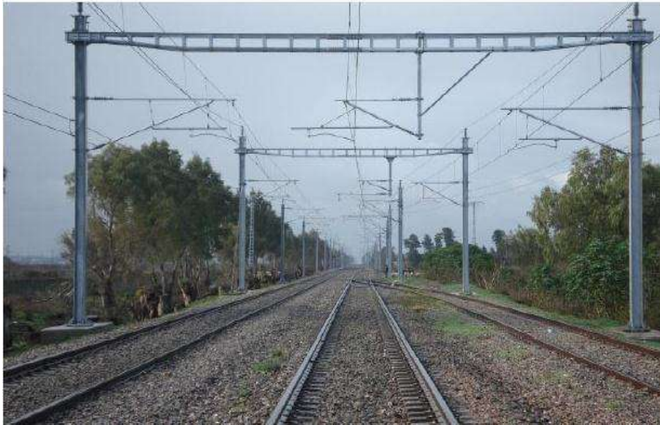
Figure II-3 : La ligne aérienne de contact .
