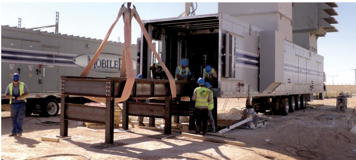
Figure0-11: Raccordement de l'alternateur par les agents d'ETTERKIB spa à Ouargla
