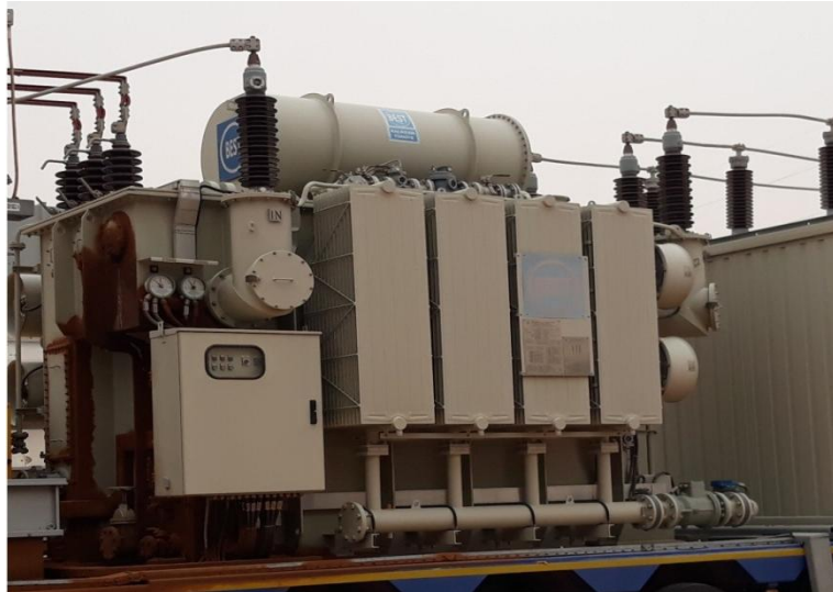
Figure IV-6: Transformateur immergé dans l'huile
