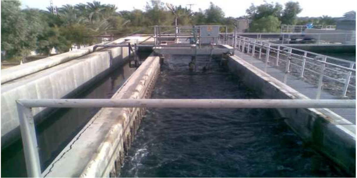
Figure (II-11) : Dessablage-déshuilage dans la station de Touggourt.
