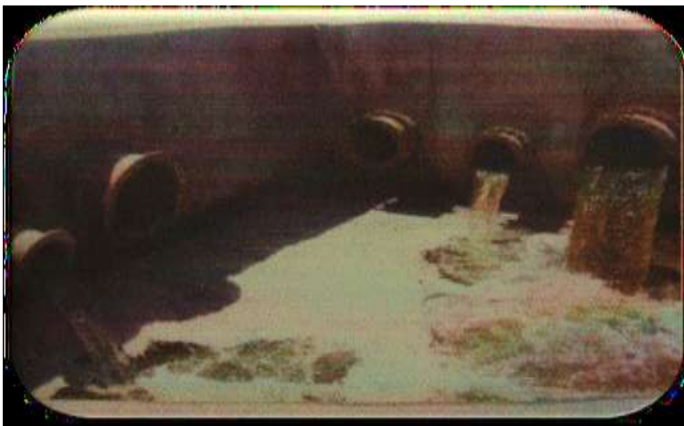
Figure (II- 03): Entrée des eaux usées à la station (bassin de dégazage).
