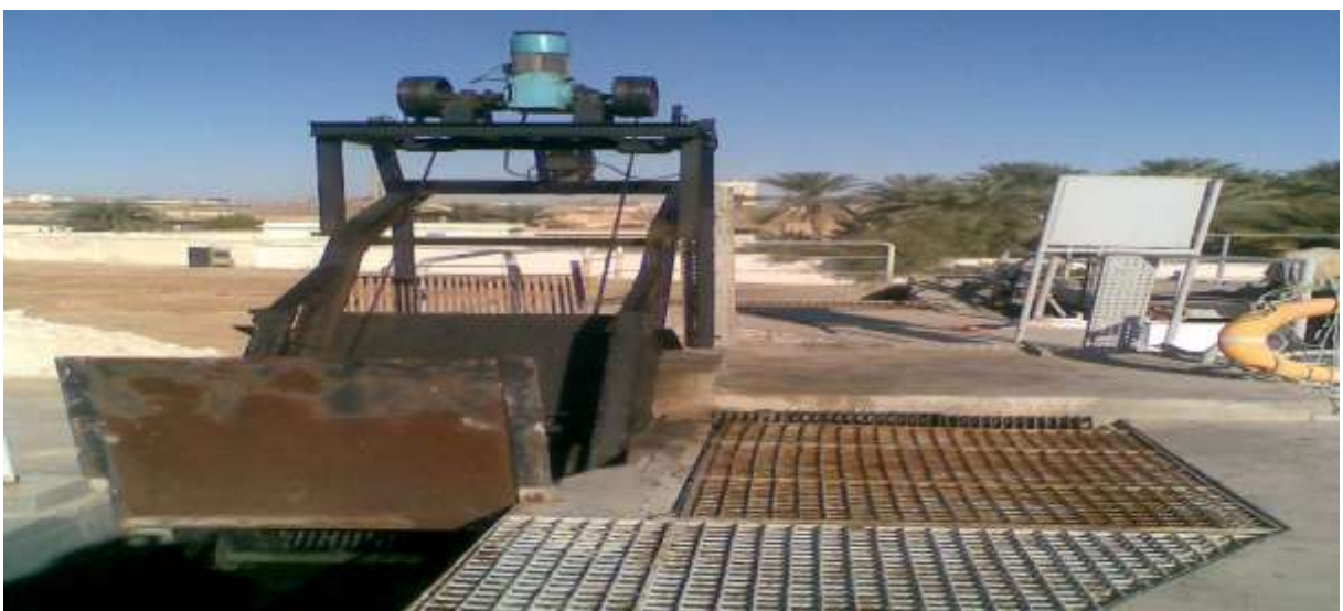
Figure (II-10): Dégrillage dans la station de Touggourt.
