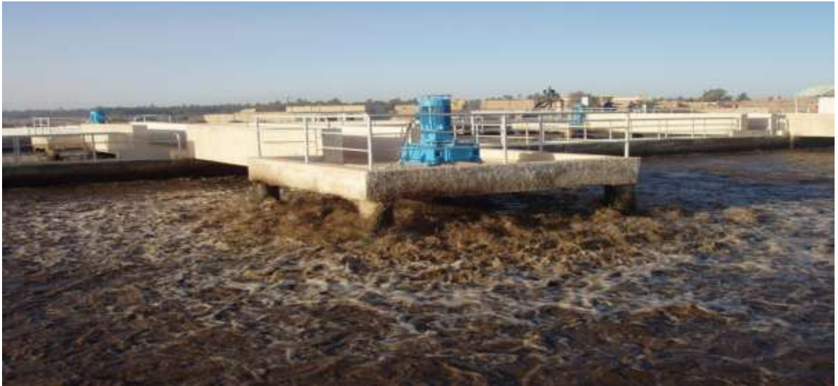
Figure (II-12) : Bassin d'aération dans la station de Touggourt.
