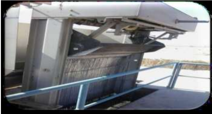
Figure (II-04) : Dégrilleur dans la station d'Ouargla.
