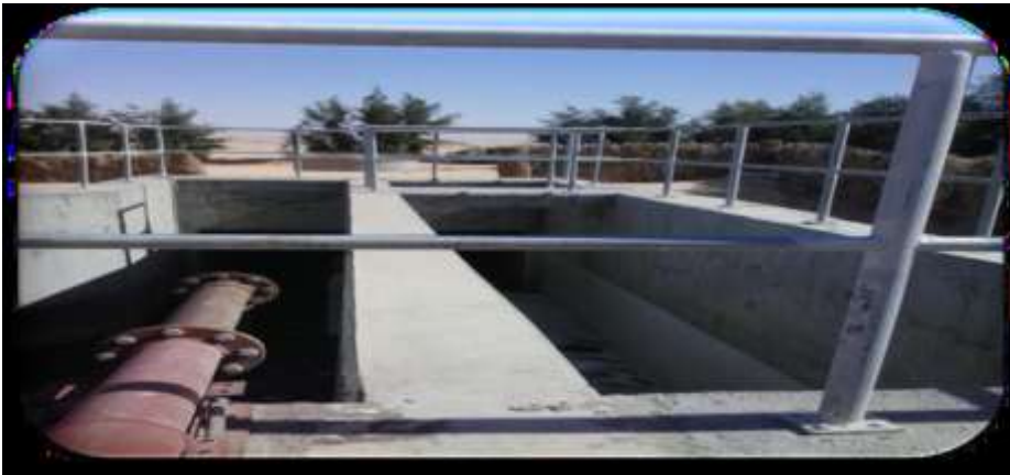
Figure (II-07): Canales de transport des eaux usées (à gauche) et des eaux de drainage (à droite) Dans la station d'Ouargla.[06]
