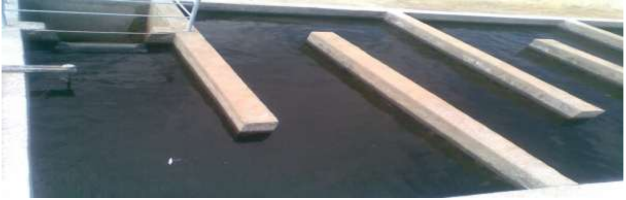
Figure (II-14) : Bassin de chloration dans la station de Touggourt.
