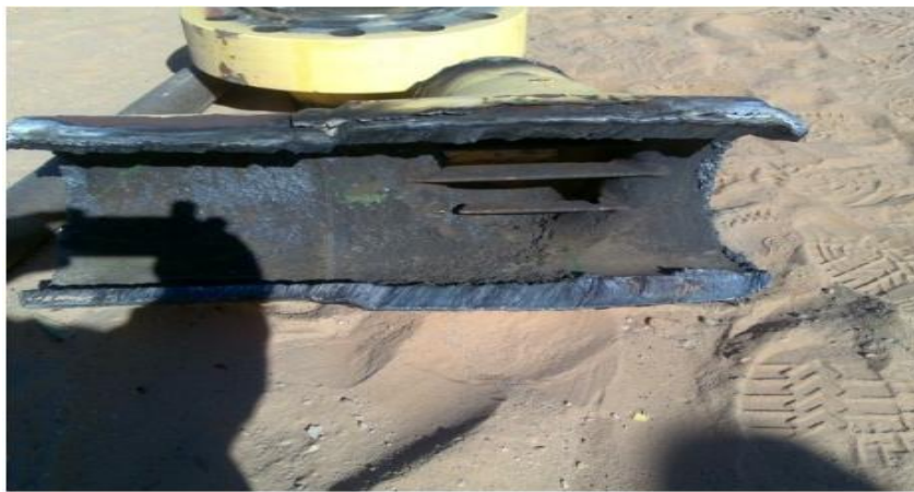
Figure II.5. Corrosion à manchette (puits HA21)
