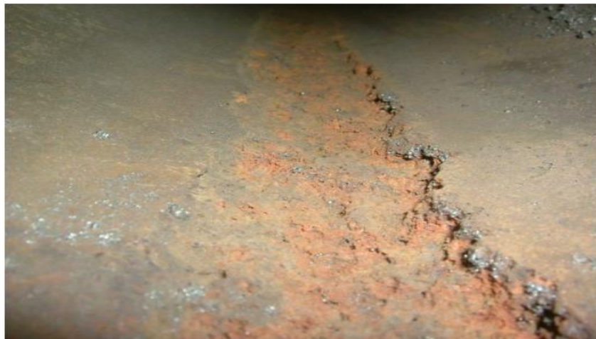
Figure II.6. Corrosion d'une conduite enterrée
