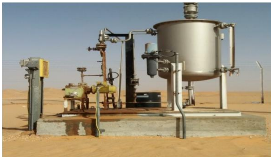
Figure III. 6. Unité de pompage d'inhibiteur
