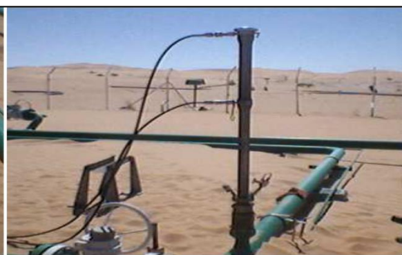
Figure 43: L'extracteur installé sur la ligne
