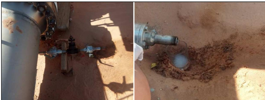
Figure 21 : vanne de purge
