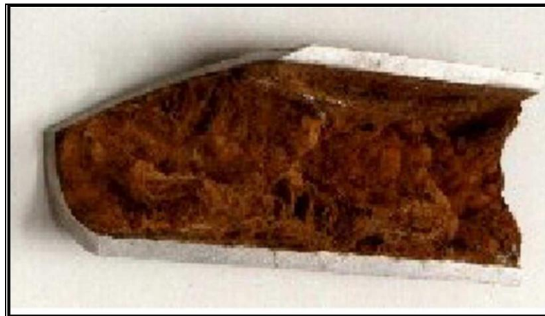
Figure 08 : Corrosion causé par bactérie.
