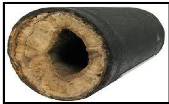
Figure II.6 : Dépôt de sulfate de calcium [12].
