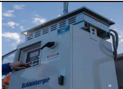
Armoire de contrôle.
