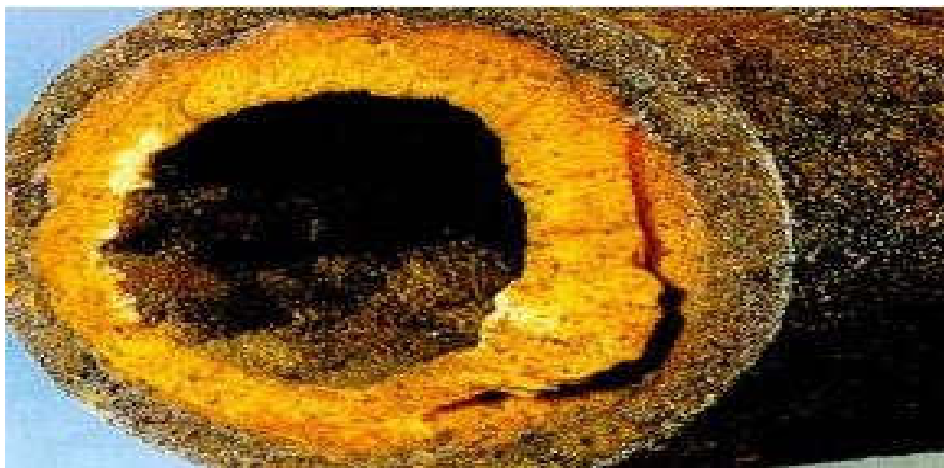
Figure II .4 : le dépôt de paraffine dans la conduit .[4]
