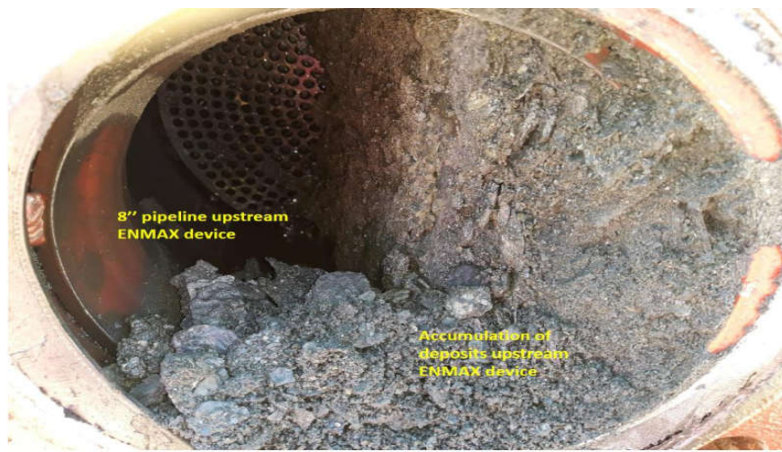
Figure V.6 : accumulation des dépôts en amont Enmax 8 ".
