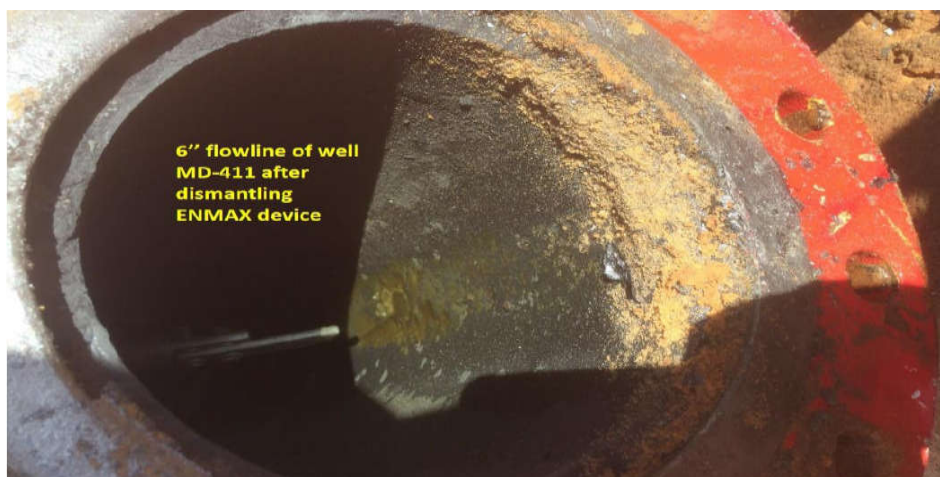
Figure IV.15 : Dépôts dans la conduite d'écoulement après démontage d'ENMAX
