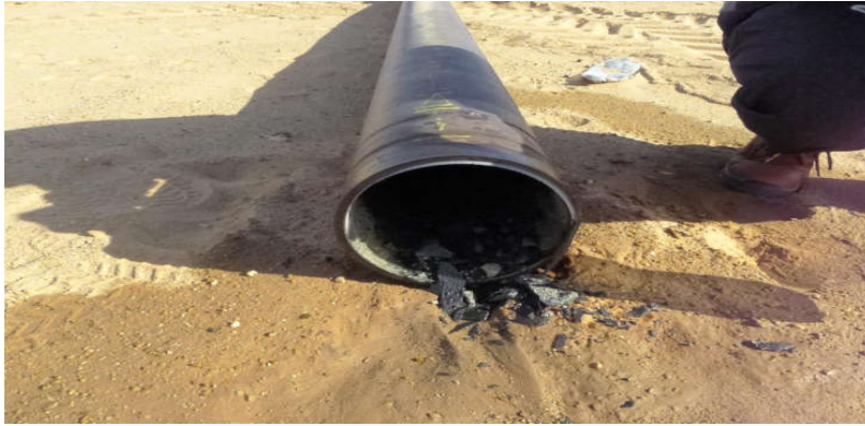
Figure V.8 : Accumulation des dépôts dans la ligne principale de 8 ".
