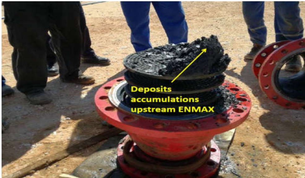
Figure V.4 : Accumulation de dépôts dans les composants internes d'Enmax 8" .
