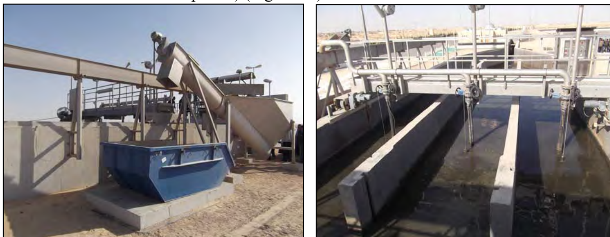
Figure 98. Ouvrage de prétraitement de STEP 1.
