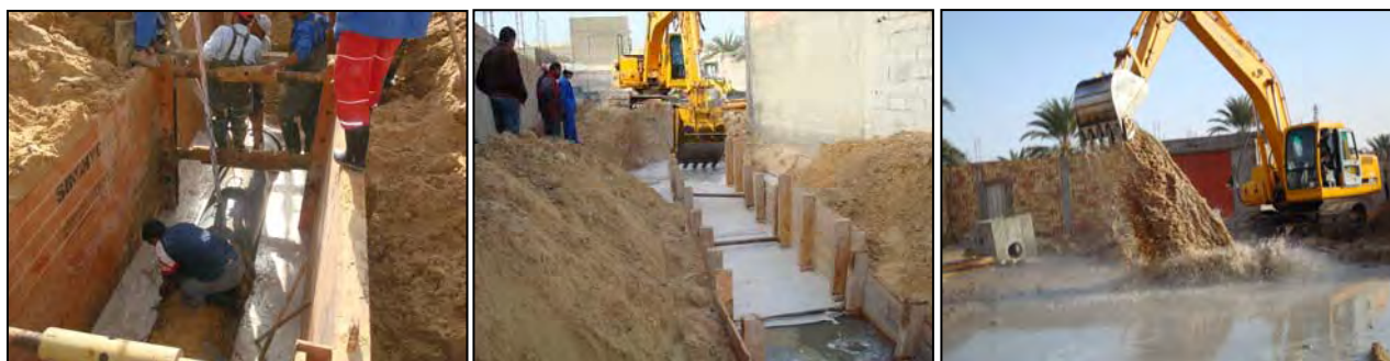
Figure 95. Les travaux des poses des conduites d'assainissement au niveau des zones menacées par le phénomène de remontée en 2008. (Photo Miloudi A.M, 2008)
