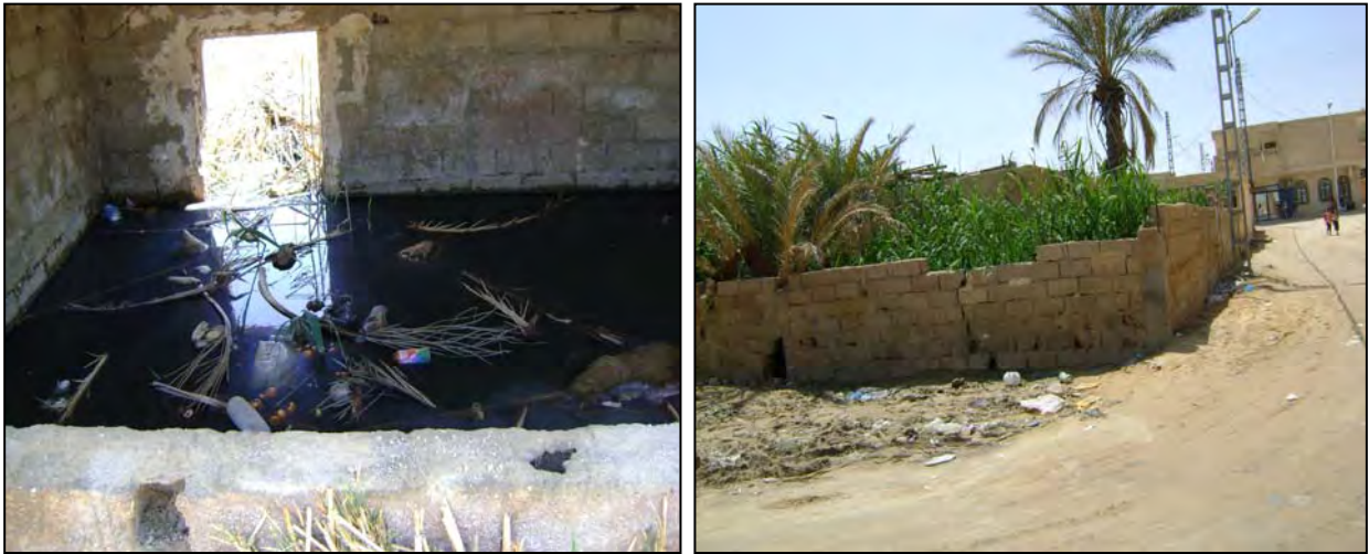
Figure 80. Des maisons abandonnées et inondées (Quartier Sidi Mestour) par les eaux de la nappe et pleines de roseaux depuis 2000.
