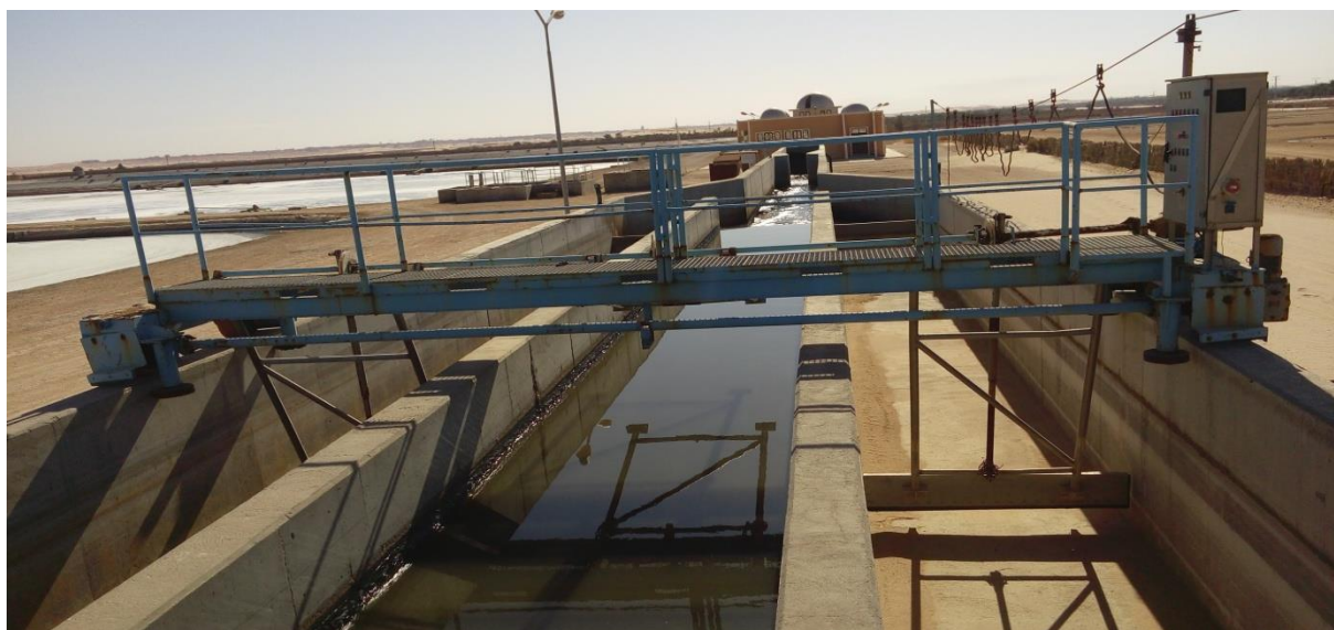
Figure (01): Les eaux usées.
