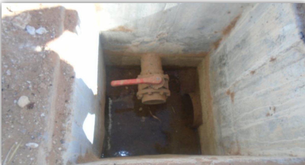
Photo (05): Regard de rassemble l'eau traitée.
