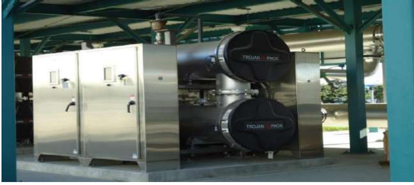
الشكل (24): وحدة المعالجة بالأشعة فوق البنفسجية بأحد محطات المعالجة.
