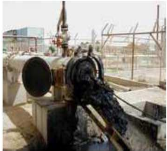
Figure II.18: Dépôt d'Asphaltène dans le réseau de collecte [24].
