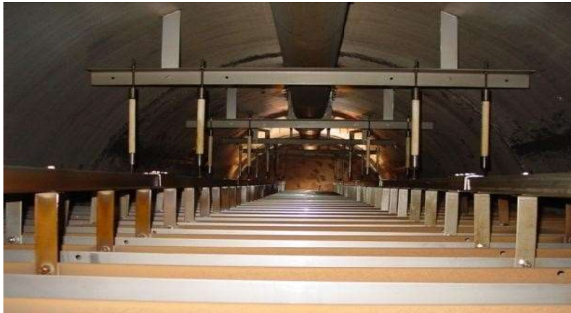
Figure III.2. Les électrodes à l'intérieur du dessaleur [13] .
