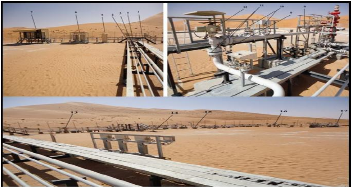
Figure I-9 : Installation de surface d'un puits producteur d'huile
