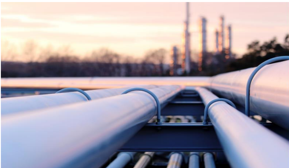
Figure I-1 : Vue générale d'un pipeline.
