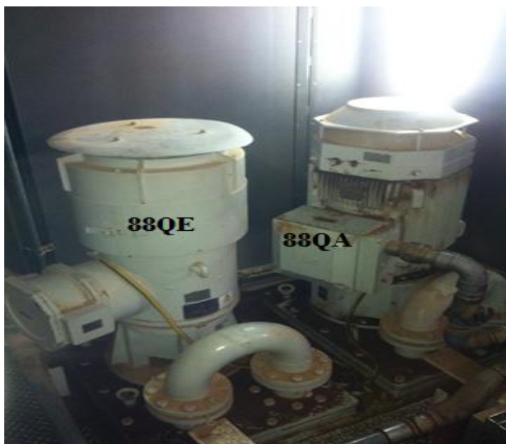
Figure II- 5.pompe auxiliaire QA et pompe de secours QE
