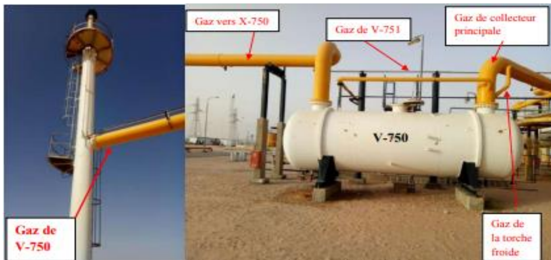
Figure IV-7 : Photographie du V-750 Figure IV-8 : Photographie du système torche de l'UTG.
