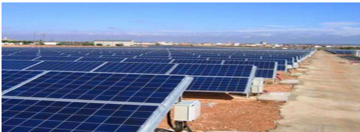
Figure I-2 : Centrale solaire Ain Skhouna à Saïda d'une capacité 30 MW depuis mai 2016
