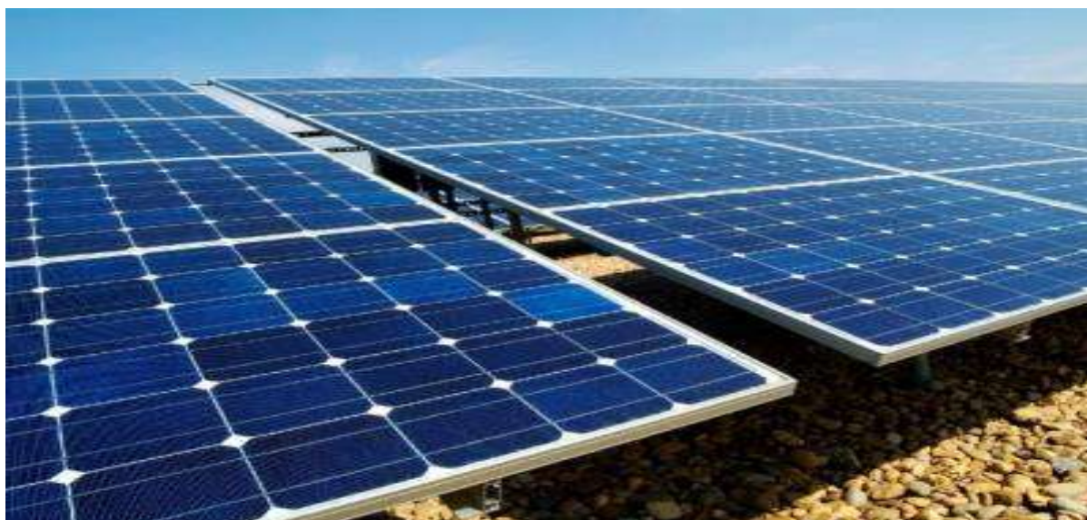
Figure I-3 : Station solaire d'Ain el Ibel Djelfa d'une capacité de 20 mégawatt
