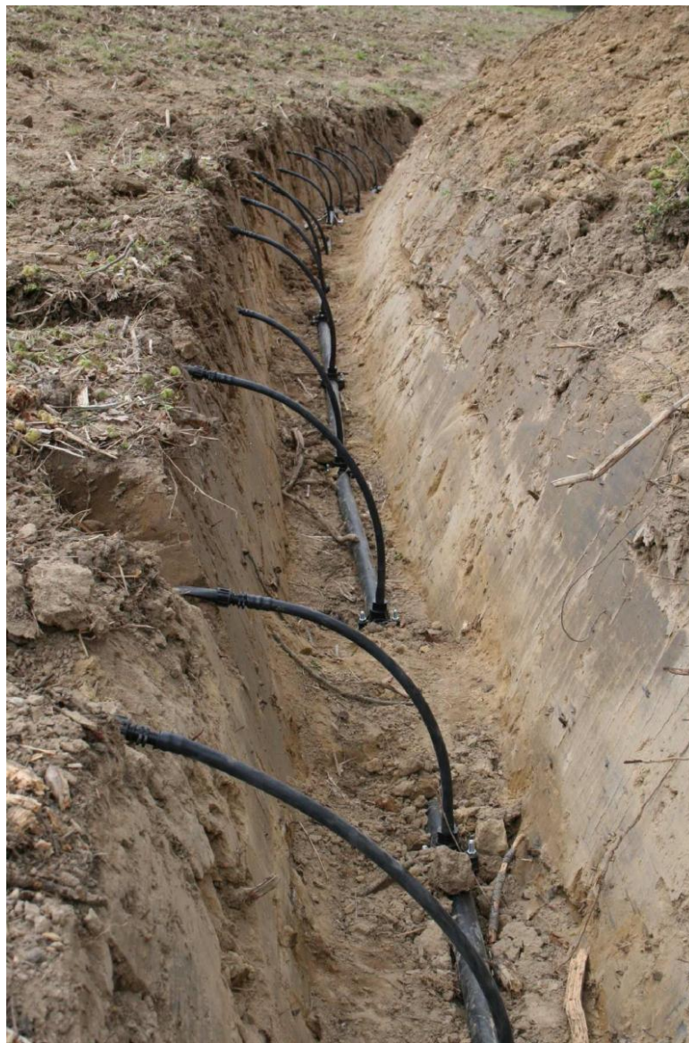
Figure I.7 Irrigation par goutte à goutte systèmes souterrains[6]
