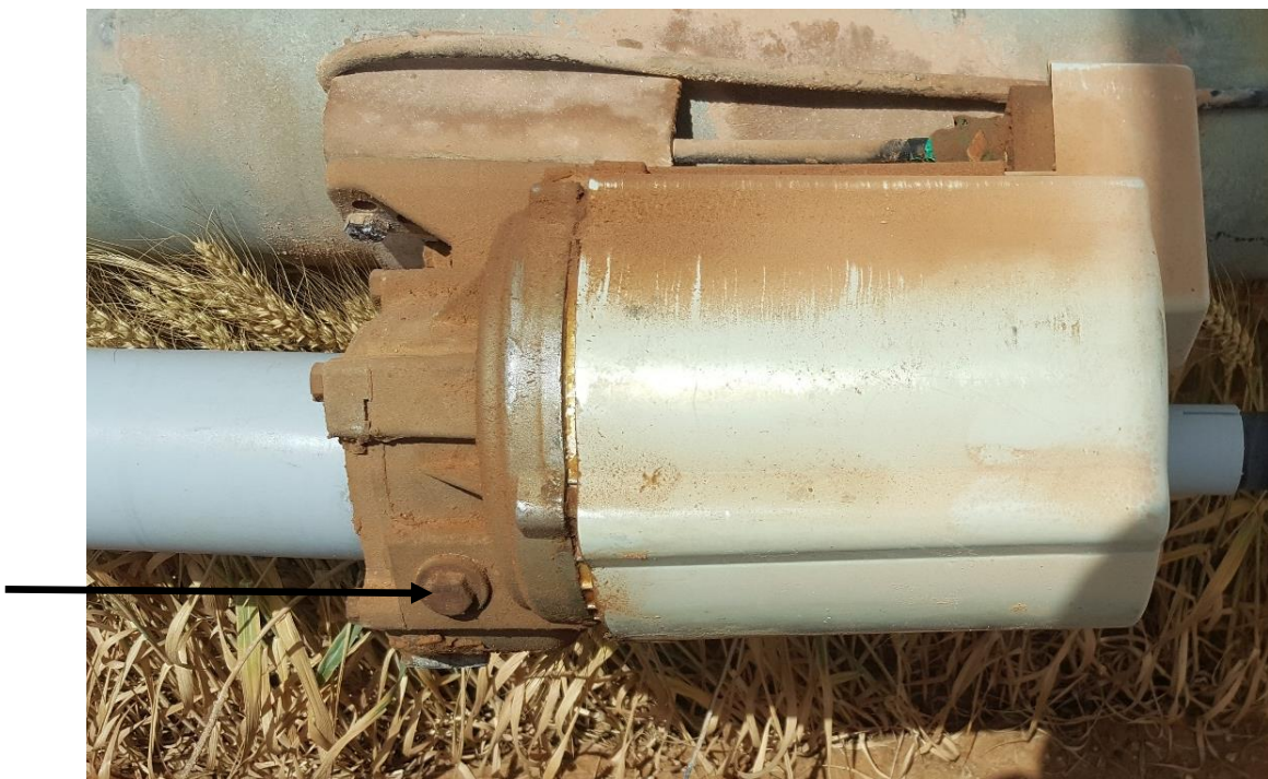
Figure IV.3 Vérification le niveau d'huile de motoréducteur
