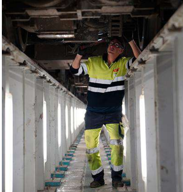
Figure (2.2) ; Fausse d'intervention de maintenance
