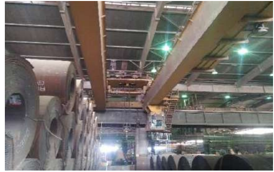
Figure I.11 Le pont roulant
