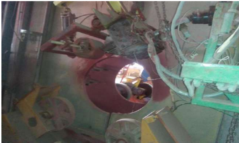
Figure I.37 La cabine de poudrage thermodurcissable
