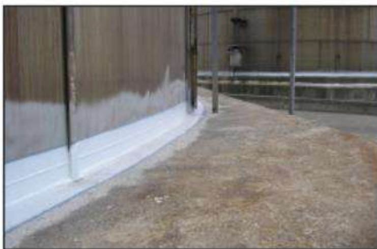
Figure II. 7: Fissure réparée et étanchéité assurée du bas du réservoir[11]
