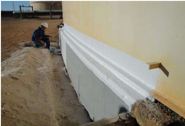
FigureII. 21: Protection avec propriétés Imperméabilisantes [10]
