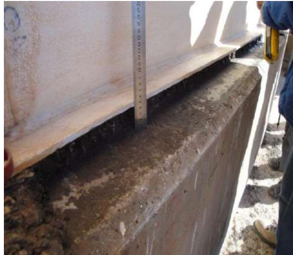
Figure II. 18 : Dégradation du béton [11]
