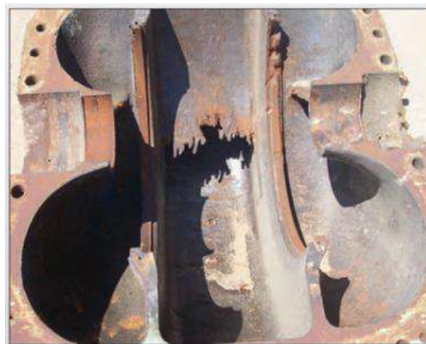
Figure II. 25 : Effets typique de l'érosion & la corrosion dans une pompe centrifuge
