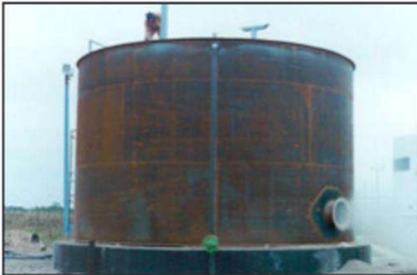
Figure II. 9 : Etat de surface extérieur du réservoir dégradé [11]
