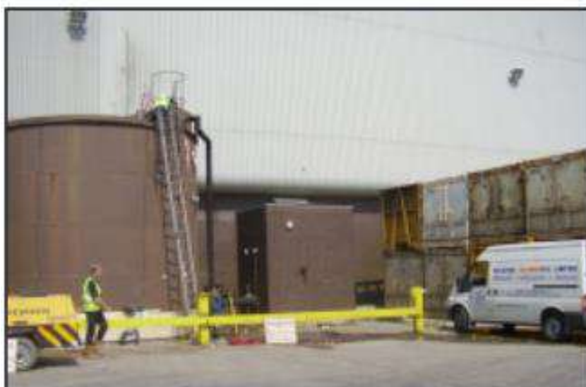
Figure II. 13 : Bac de stockage a réparé [11]
