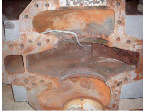
Figure II. 26 : Dommages causés par la corrosion et la cavitation
