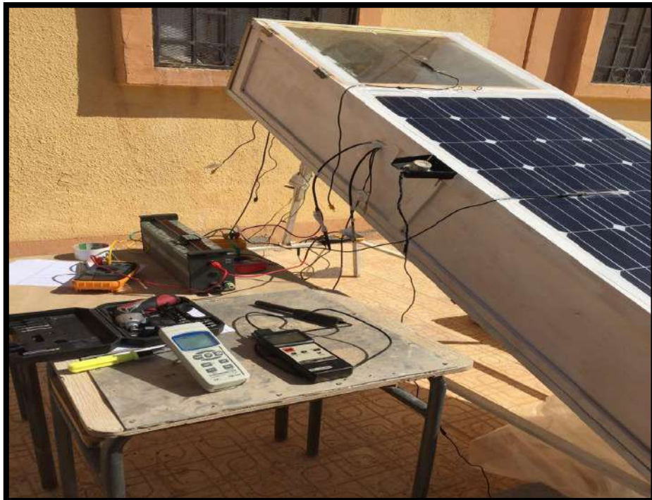
Figure 3. 13: Appareils des mesures connectés au système PV/T.
