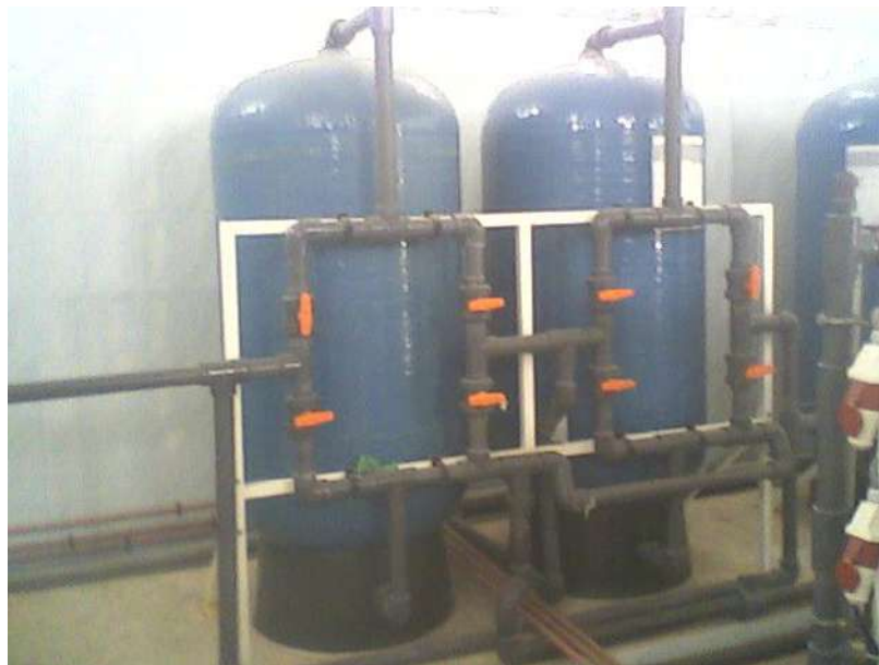
Figure IV-1 : filtre à sable
