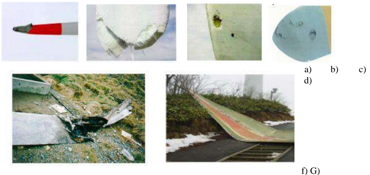
Fig. I.5 a) défaut dans les pales ; b) buron out de la pale et fusion de fil ; c) Effondrement et destruction de la pale.
