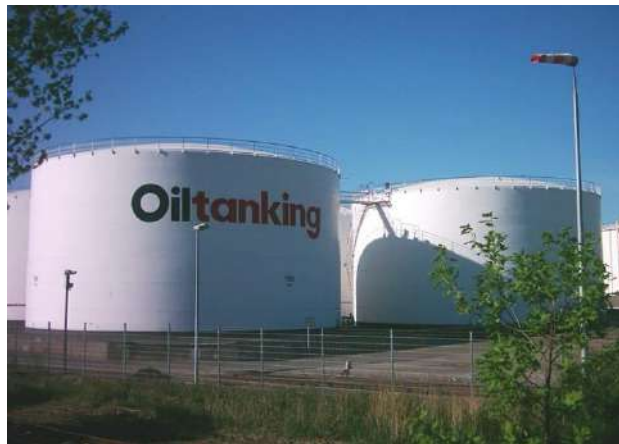
Figure 13. Bac de stockage pour la déshydratation du pétrole brut.
