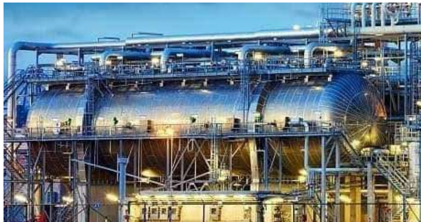
Figure 1. Photos du dessaleur installé à l'échelle industriel pour le dessalage du pétrole brut.
