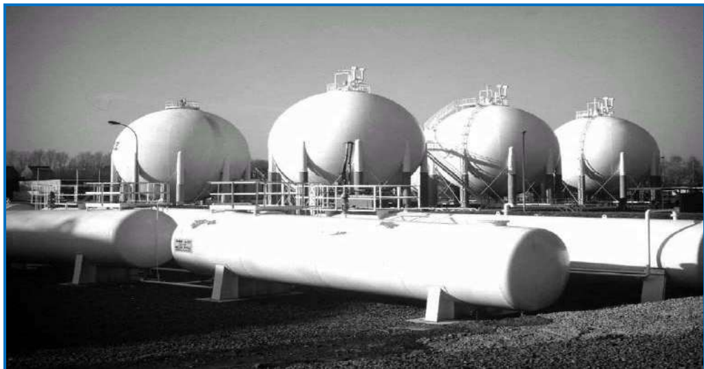
Figure I-2 Vue extérieure de réservoirs sous pression [2].
