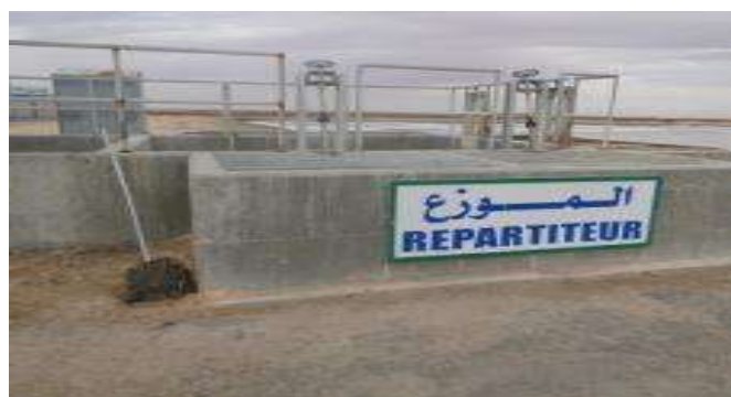
FIGURE (IV-6): Répartiteur de la station d'épuration Ouargla .
