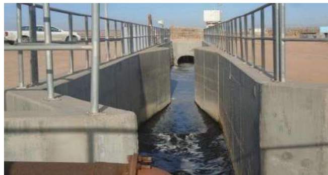
FIGURE (IV-8): Canal de transport de la station d'épuration Ouargla ( Station d'épuration said Otba Ouargla ).
