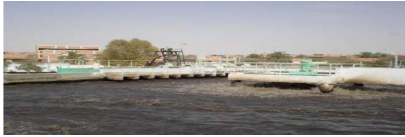
Figure III.9 Le bassin d'aération
