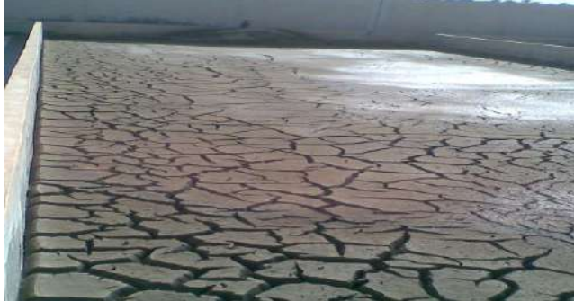
Figure III.14 Les lits de séchage
