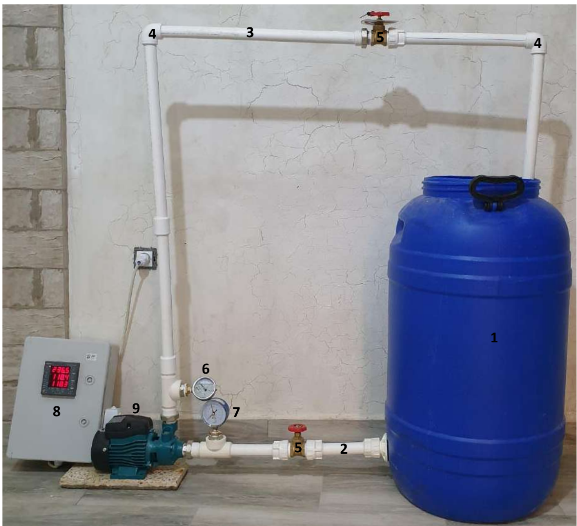
Figure III-8 : Image du banc d'essai d'expérimentation de la pompe
