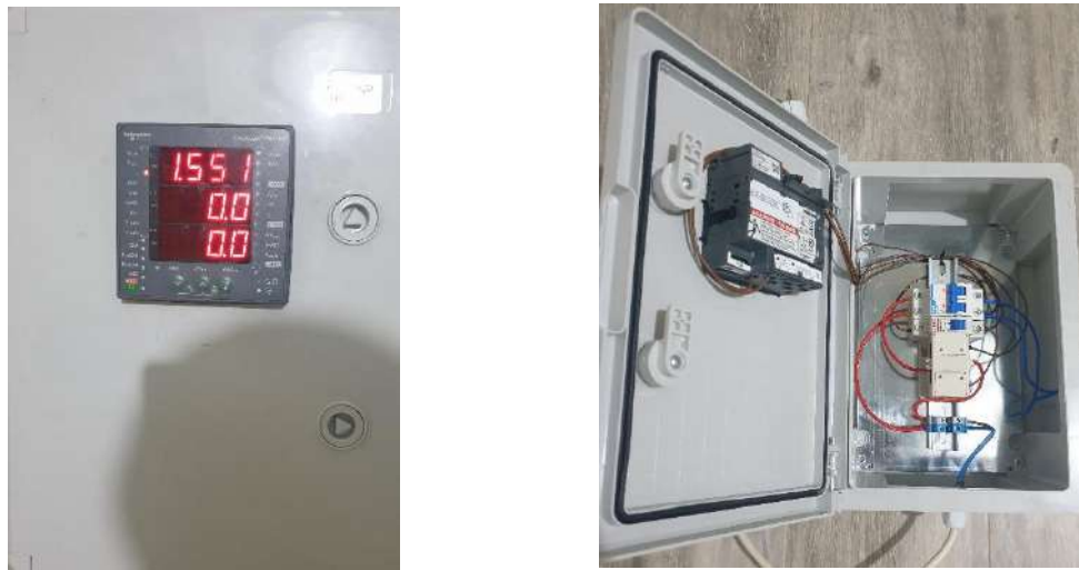
Figure III-3 : Armoire électrique équipée par compteur EasyLogic™ séries PM2100
