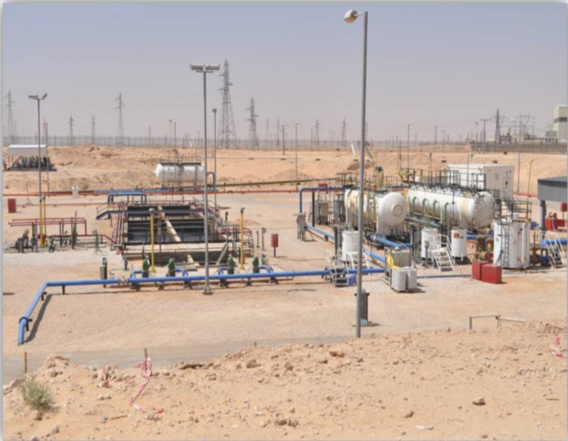
Figure II.8: Unité de traitement des eaux huileuse API- CINA [15]
