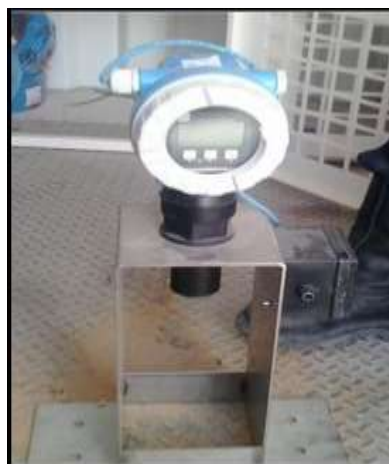
Fig.3.32: Capteurs de niveaux de bac
