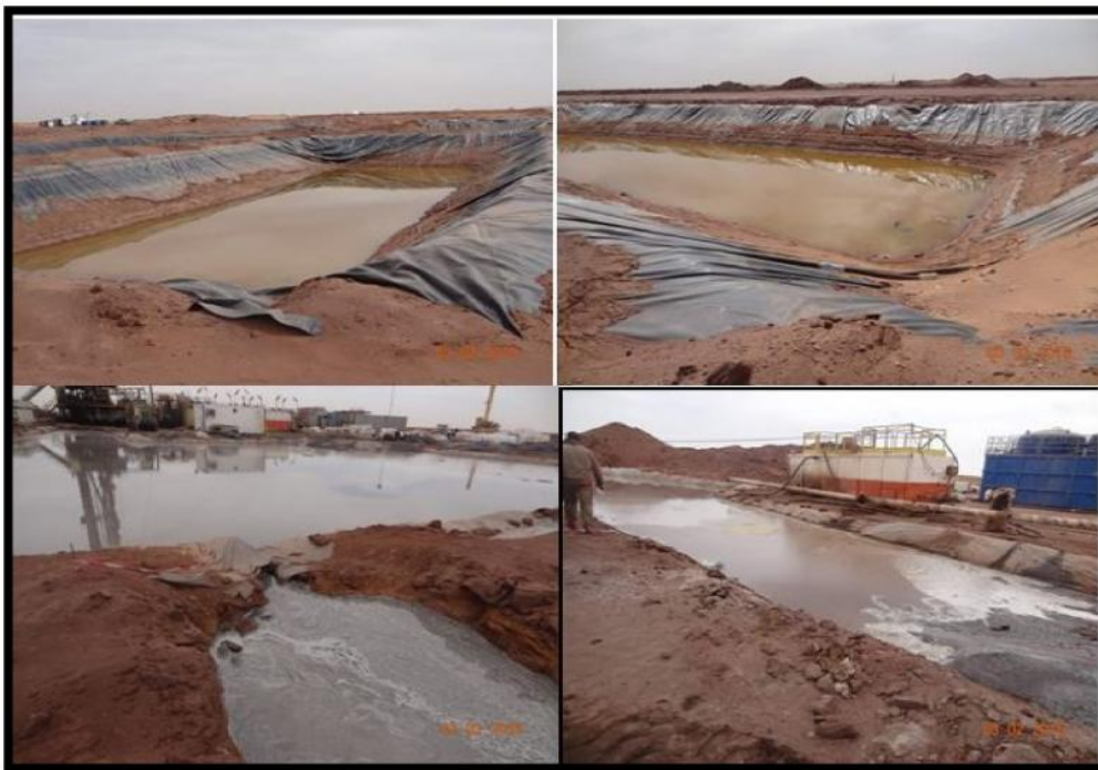
Figure II.2. Les bassins de décantation d'Ahnet à In Salah
